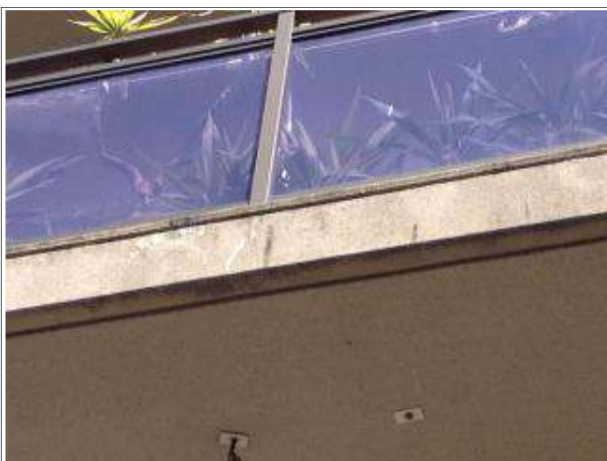
外壁 クラック部
