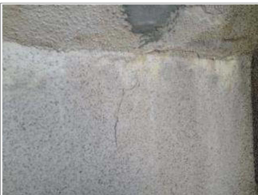
外壁 クラック部
