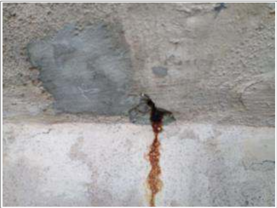
外壁・天井 爆裂部
