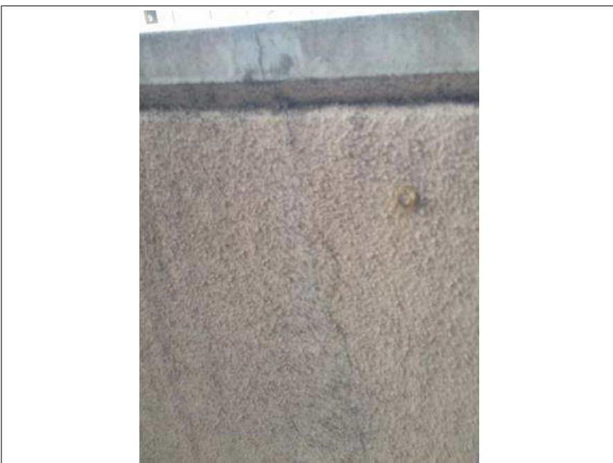
外壁 クラック部
