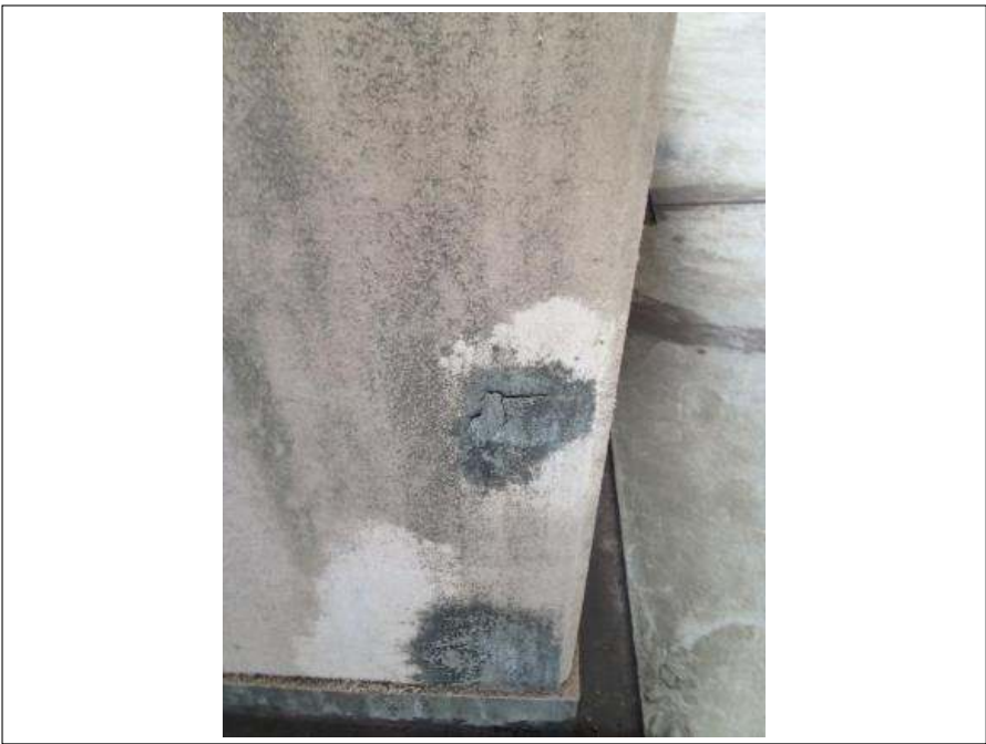
外壁・天井 爆裂部
