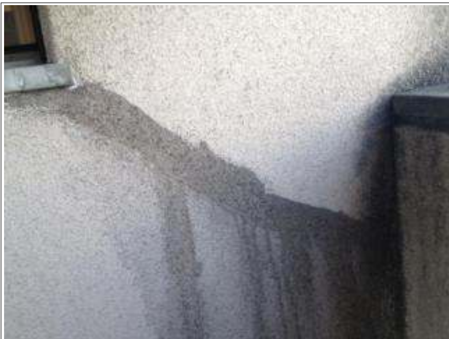
外壁 クラック部
