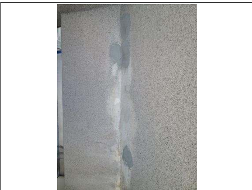
外壁 剥離・浮き部
