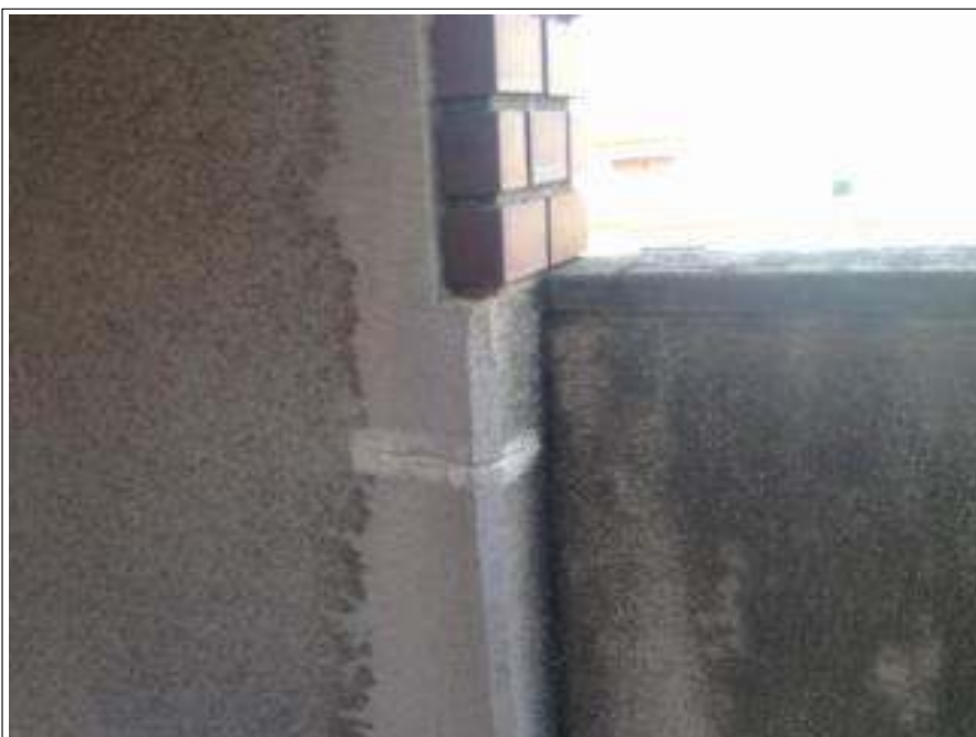
外壁 クラック部
