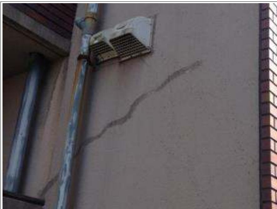
外壁 クラック部
