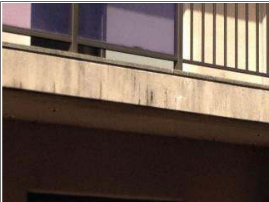
外壁 クラック部
