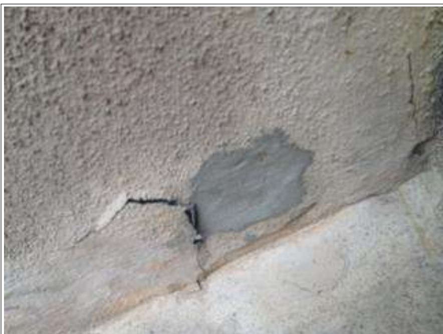
外壁・天井 爆裂部
