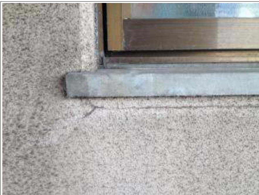
外壁 クラック部
