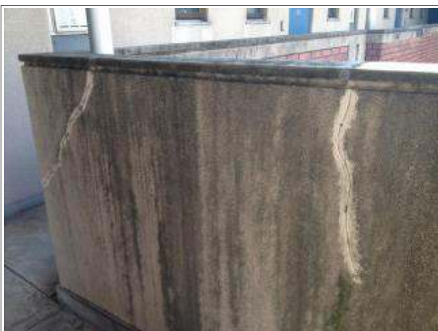
外壁 クラック部
