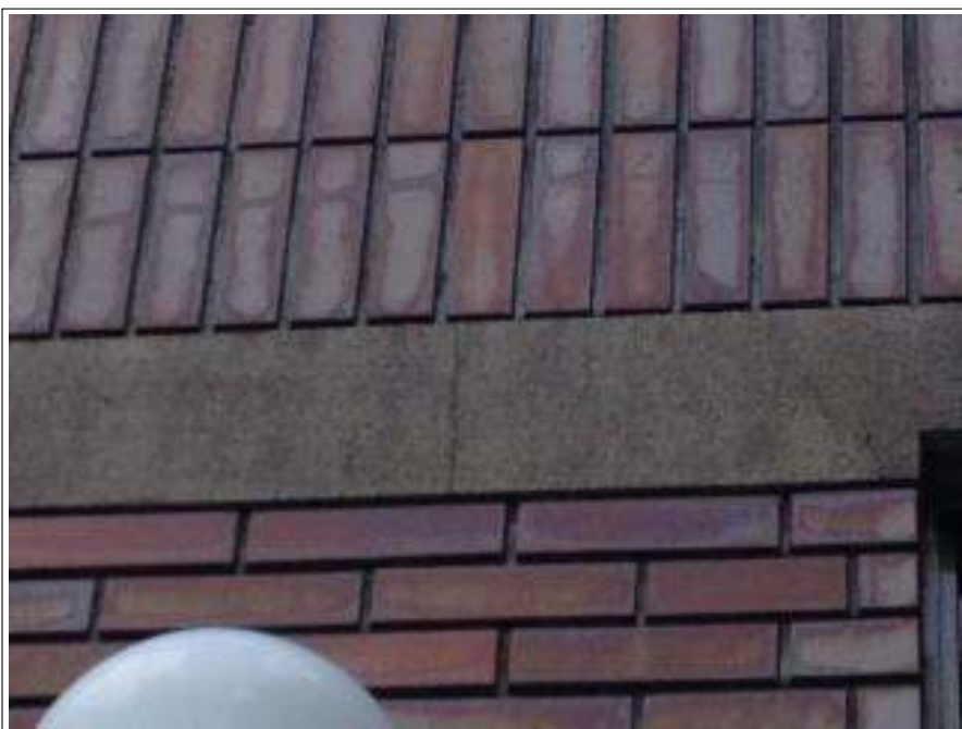
外壁 クラック部
